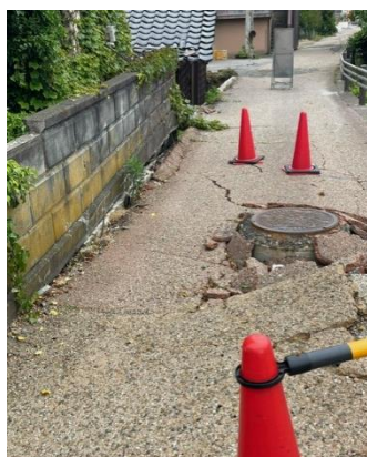
割れてしまった地面。
